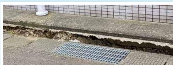
活動拠点の建物も地割れで傾いていました
